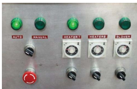
ตรวจสอบการทำงานของเครื่องทำความร้อนที่ 1 และนาฬิกาจับเวลาของเครื่องทำความร้อนที่ 1
