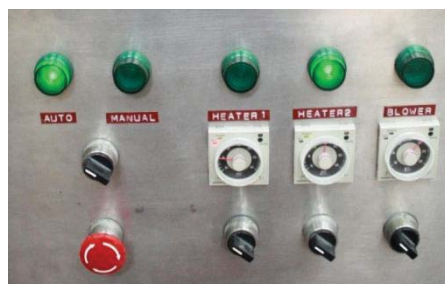
ตรวจสอบการทำงานของเครื่องทำความร้อนที่ 2 และนาฬิกาจับเวลาของเครื่องทำความร้อนที่ 2
