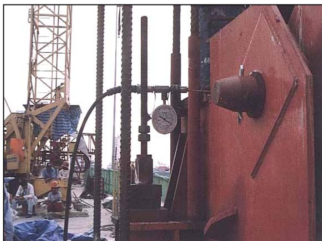
ภาพผนวกที่ ๘2 ตรวจสอบค่าความดันจาก Pressure Gauge
