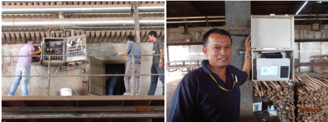
รูปที่ 5.16 การติดตั้งระบบควบคุมการอบไม้ที่พัฒนาขึ้นเข้ากับเตาอบไม้ยางพาราของบริษัทไทยนครพาราวิวด จำกัด ครั้งที่ 1 วันที่ 1 กันยายน 2555
