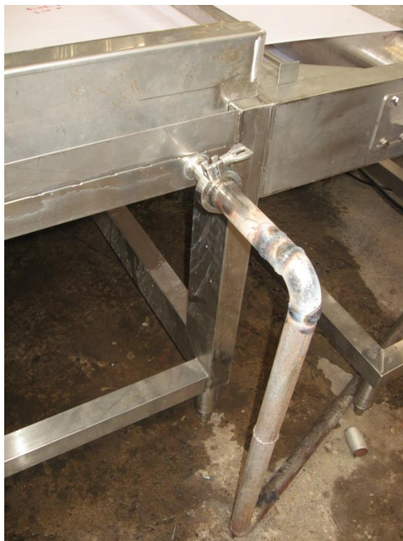
รูปที่ ข.5 ทางเข้าไอน้ำเครื่องนี้
