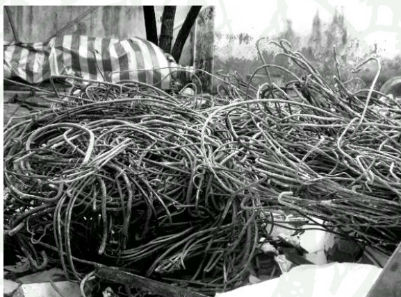
ภาพผนวกที่ ๘ ลักษณะของเหล็กที่ถูกแยกออกจากส่วนของคอนกรีต
