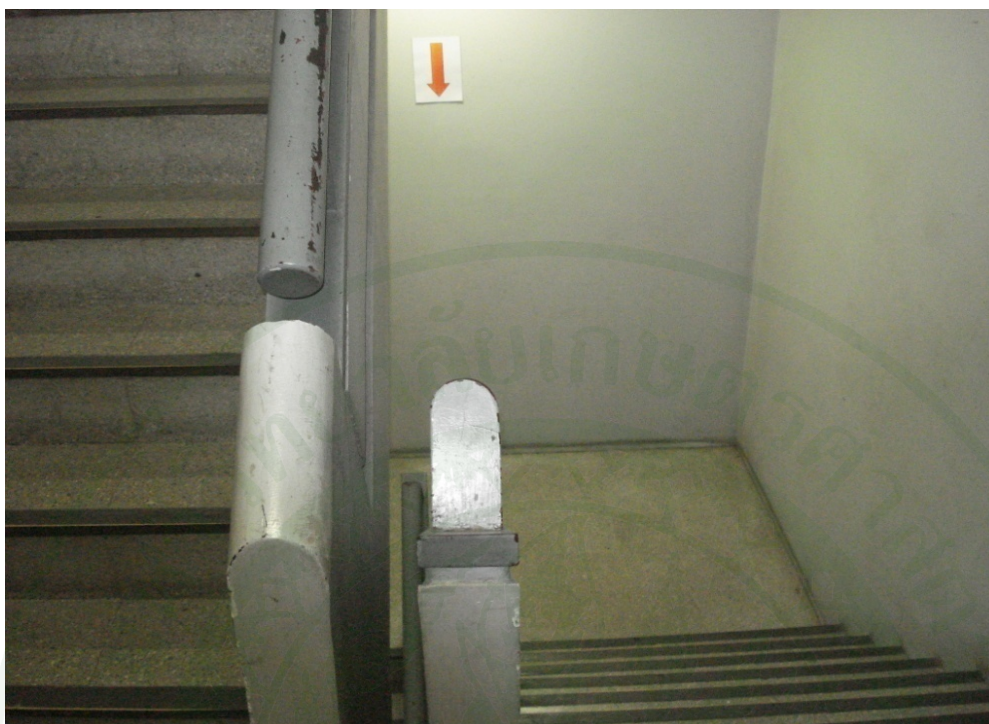
ภาพที่ 33 ราวจับบันไดหนีไฟ FST-2 ที่จะต้องติดตั้งราวจับเพิ่มอีก 1 ด้าน
