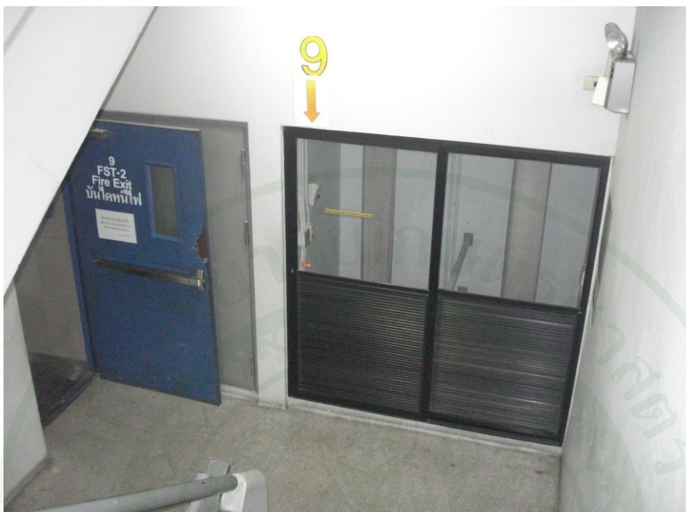
ภาพที่ 35 ป้ายสัญลักษณ์ในบันไดหนีไฟที่ติดตั้งอยู่แล้ว
