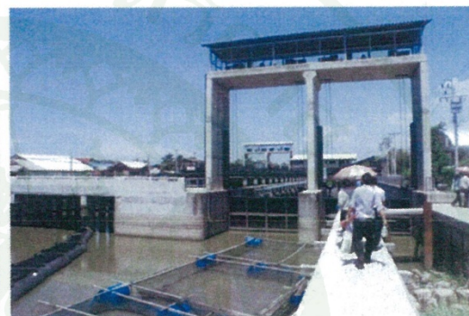
สถานีสูบน้ำและประตูระบายน้ำหนองจอก
