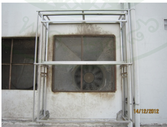
ภาพที่ 1 ปล่องลมปล่อยทิ้งจากกระบวนการกำจัดละอองฝ้ายของบริษัท ด้าซิงคอตตอนไทย
