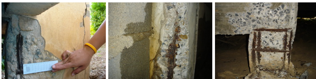
รูปที่ 2-1 ความเสียหายของโครงสร้างต่อม่อโดยทั่วไป บริเวณหอพักนิสิต
