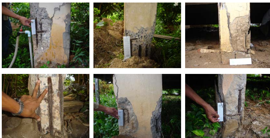
รูปที่ 1-7 การชำรุดเสียหายของโครงสร้างคอนกรีตเสริมเหล็ก
