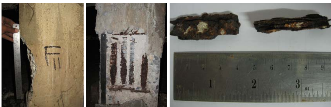
รูปที่ 1-4 การเกิดสนิมของเหล็กเสริมในโครงสร้างต่อม่ออาคาร 1 คณะวิศวกรรมศาสตร์ กำแพงแสน
