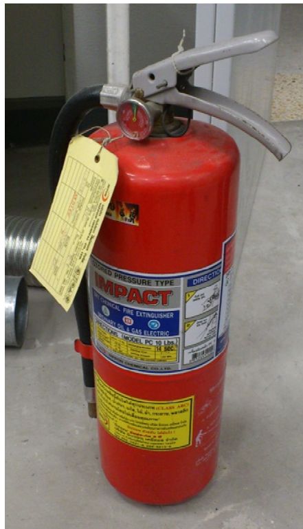
รูปที่ ก.19 รูปถ่ายถังดับเพลิง
