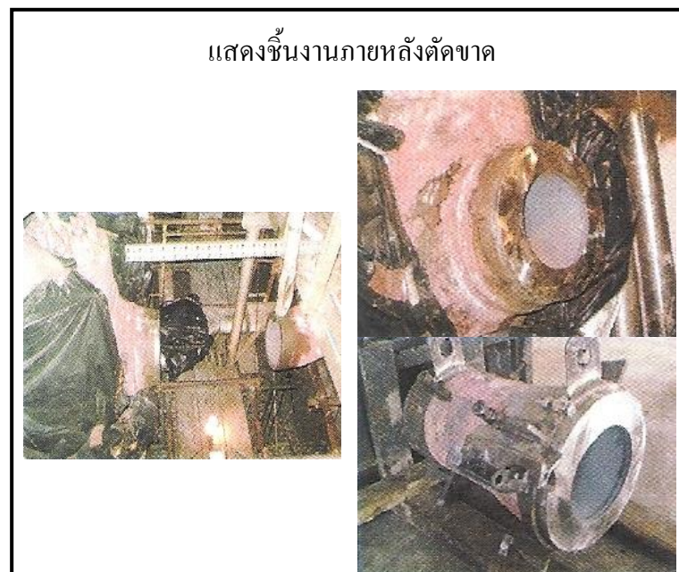
รูปที่ 3.10 ท่อ Expander หลังทำการตัดออกจาก Main Steam Stop Valve
