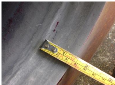
พบรอย Crack ด้านในท่อ Expander
