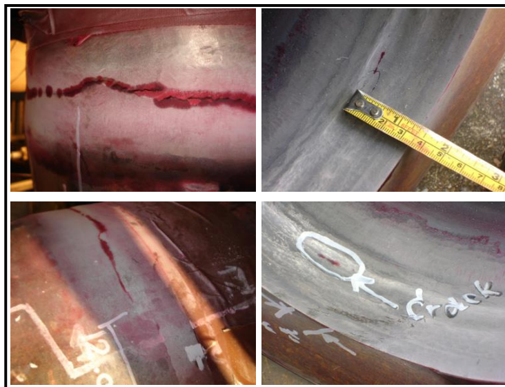
รูปที่ 1.7 รอย Crack ที่เกิดภายนอก และภายในผิวท่อ
