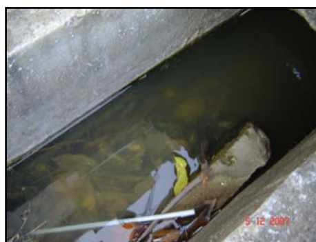
รูปที่ 3.3 แสดงน้ำจากท่อระบายน้ำทิ้งตึก 7 มหาวิทยาลัยนครสวรรค์
