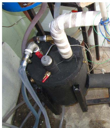
รูปที่ 3.22 ถังขับเคลื่อนน้ำของระบบหมุนเวียนน้ำด้วยพลังงานความร้อนระบบที่ 3
