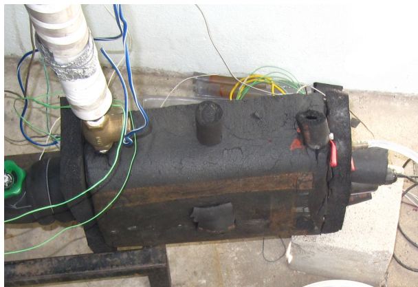
รูปที่ 3.21 ถังผลิตไอรอบบวมวนเวียนน้ำด้วยพลังงานความร้อนระบบที่ 3
