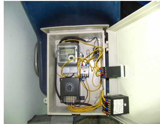
รูปที่ 3.27 Kilowatt hour meter ระบบที่ 3
