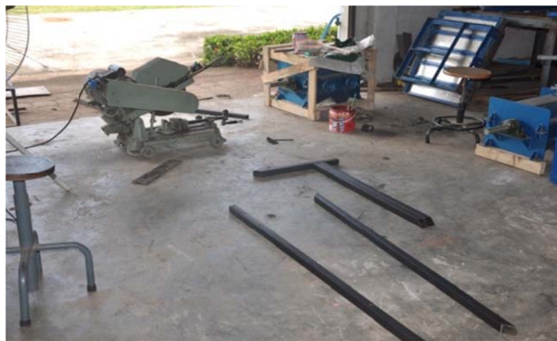
รูปที่ 3.12 การวัดและตัดเหล็ก โครงสร้างให้ได้ขนาดตามแบบ
