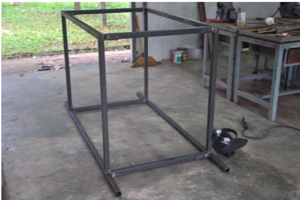
รูปที่ 3.14 ฐานโครงสร้างที่ประกอบเสร็จเรียบร้อยแล้ว
