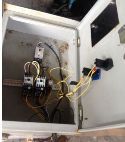
รูปที่ 3.13 ตู้ควบคุมระบบ
