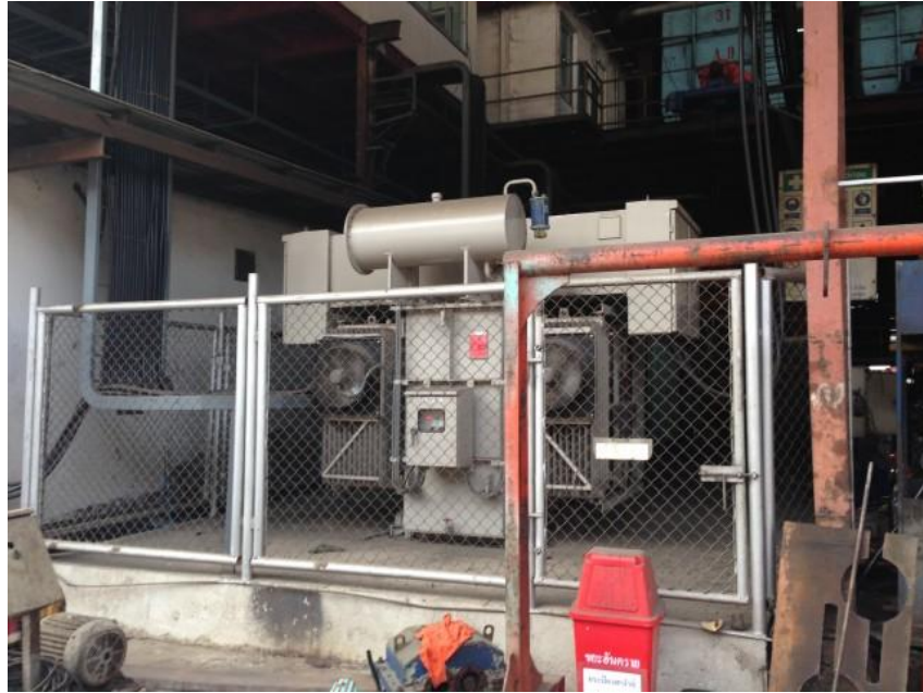
รูปที่ ก.1 หม้อแปลงไฟฟ้าที่ใช้ในงานวิจัย
