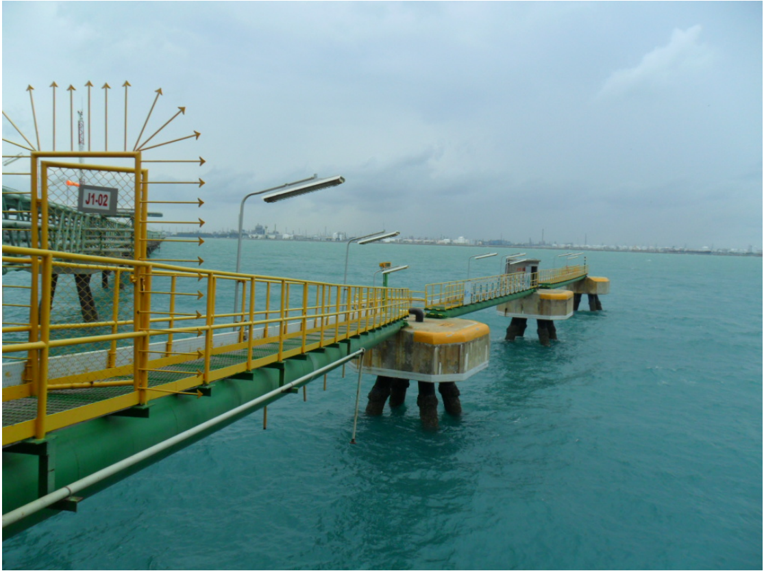
รูปที่ 1.5 ภาพถ่ายของโครงสร้างรองรับท่อส่งปิโตรเลียม (Jetty Bridge)
