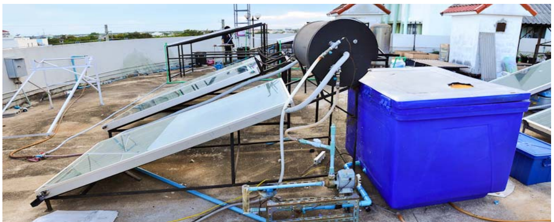
รูปที่ 3.32 การทดสอบระบบทำน้ำร้อนด้วยพลังงานแสงอาทิตย์ ตามมาตรฐาน ISO 9459-2 (ด้านข้าง)
