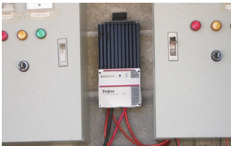
รูปที่ 3.5 เครื่องควบคุมการชาร์จเซลล์แสงอาทิตย์ (Solar controller)
