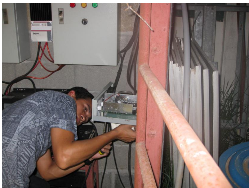
รูปที่ 3.22 แสดงการเดินสายไฟเพื่อต่อจากเครื่องกำเนิดไฟฟ้าเข้ากับชุดควบคุมการชาร์จ
