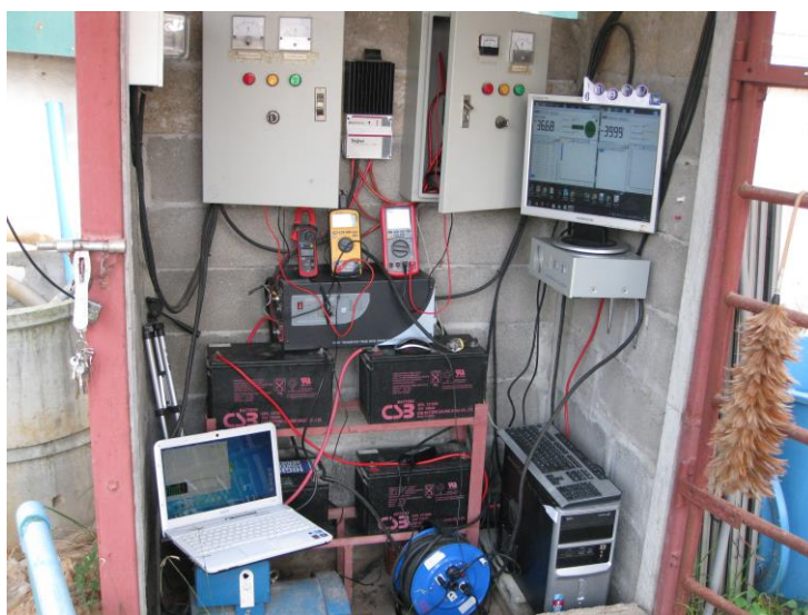
รูปที่ 3.25 อุปกรณ์และแผงควบคุม
