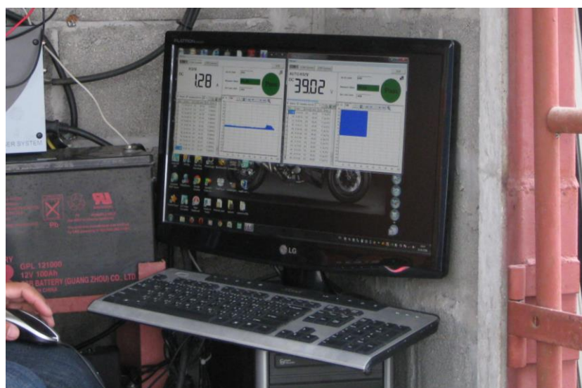
รูปที่ 3.28 เก็บข้อมูล แรงดันไฟฟ้าและกระแสไฟฟ้าของเครื่องกำเนิด
