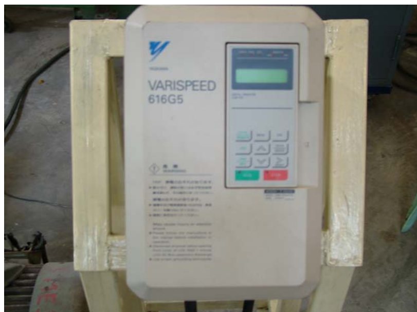
รูปที่ 5.3 อุปกรณ์ปรับความเร็วมอเตอร์ของเครื่องจ่ายอากาศ
