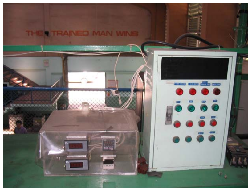
รูปที่ 5.5 ชุดควบคุมอุปกรณ์การทดลอง
