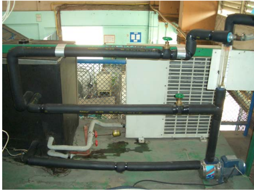
รูปที่ 5.4 ระบบท่อน้ำ
