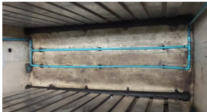
รูปที่ 3.11 ลักษณะระบบการระบายความร้อนภายในบ่อ hard anodized อลูมิเนียม
