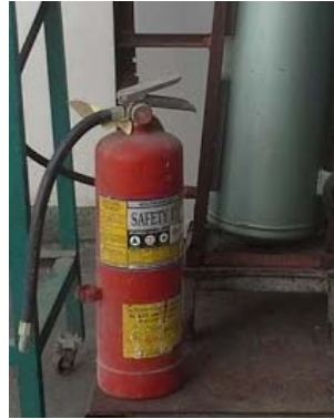
รูปที่ ก.24 ถังดับเพลิง
