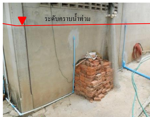
รูปที่ 4.2 แสดงระดับของคราบน้ำท่วมในบริเวณพื้นที่รอบๆประตูระบายน้ำบางโฉมศรี
