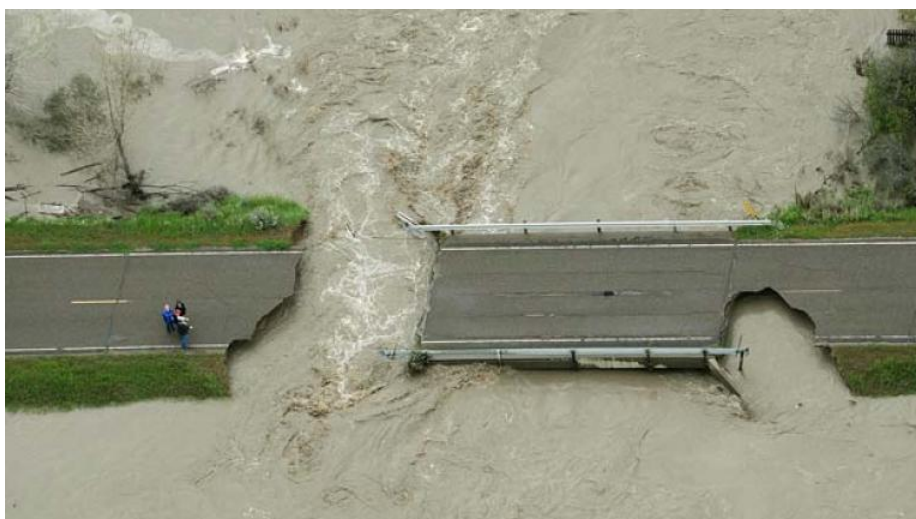
รูปที่ 2.7 ความเสียหายของสะพานจากการเกิดอุทกภัย
