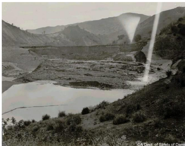
รูปที่ 2.22 การพืดแบบเลื่อนไถลของเขื่อน Calaveras ระหว่างการก่อสร้าง ที่มา : California Department of Safety of Dams
