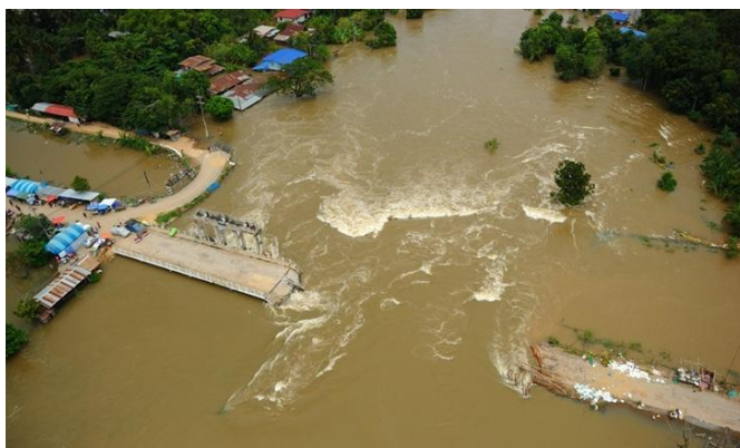
(ก) ช่องขาดบริเวณประตูระบายน้ำบางโจมศรี
