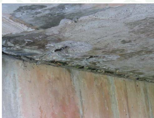
ภาพที่ 13 การหลุดกะเทาะบริเวณใต้พื้นสะพาน
