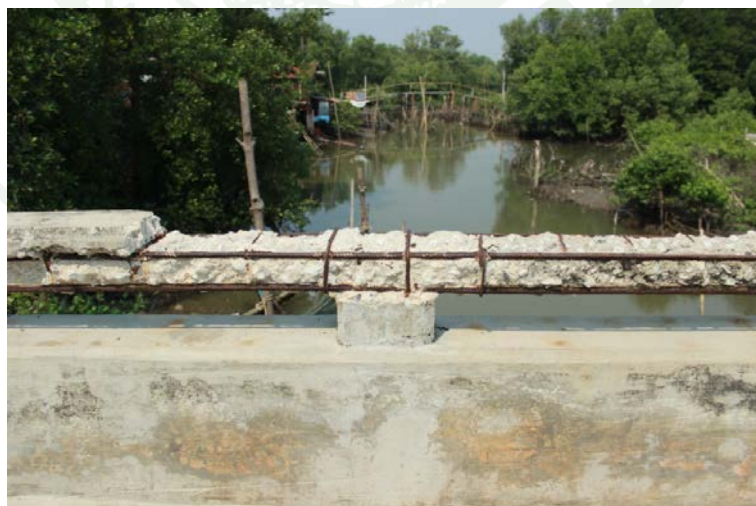
ภาพที่ 2 ความเสียหายจากการเป็นสนิมของราวสะพานคอนกรีตเสริมเหล็กเนื่องจากไอเกลือในบรรยากาศ
