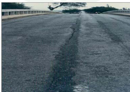
ภาพที่ 10 รอยแตกร้าวที่พื้นด้านบนสะพาน
