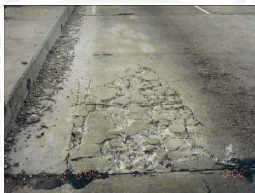
ภาพที่ 11 การหลุดกะเทาะบริเวณพื้นด้านบนสะพาน
