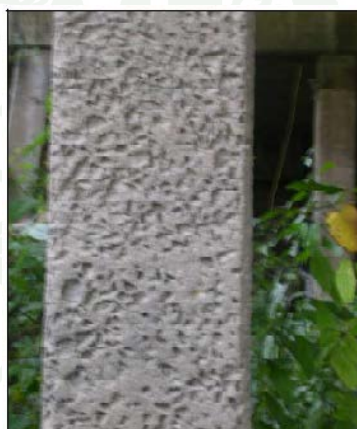
ภาพที่ 20 การสึกกร่อนบริเวณตอม่อสะพาน
