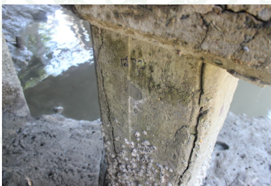
ภาพที่ 18 การแตกร้าวที่เสาของสะพาน
