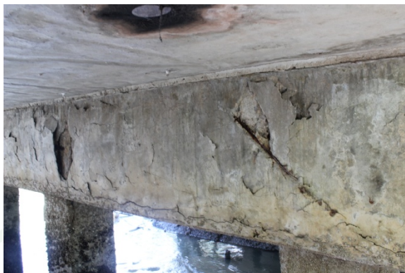
ภาพที่ 15 การแตกร้าวบริเวณคานขวางของสะพานเนื่องจากสนิม
