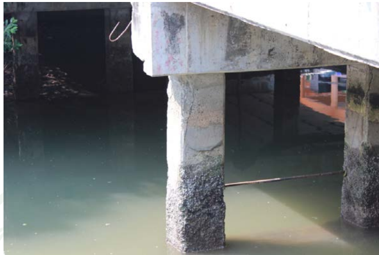
ภาพที่ 1 ความเสียหายจากการเป็นสนิมของเสาคอนกรีตเสริมเหล็กเนื่องจากคลอไรด์ไอออนในน้ำทะเล
