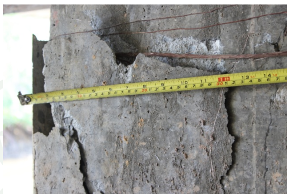
ภาพที่ 19 การหลุดกะเทาะที่เสาของสะพาน
