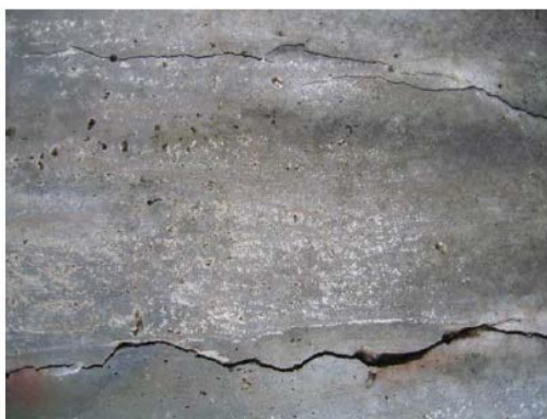
ภาพที่ 12 รอยแตกร้าวที่พื้นด้านใต้สะพาน
