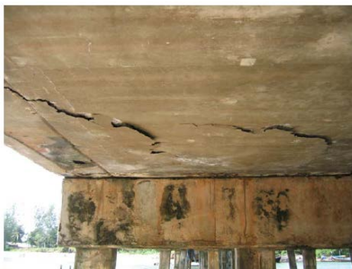
ภาพที่ 14 การหลุดลอกบริเวณใต้พื้นสะพาน
