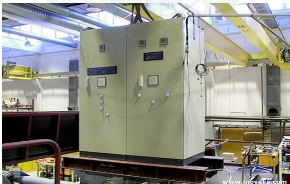
ภาพที่ 91 ตัวอย่างตู้ไฟฟ้าที่ติดตั้งขณะทำการทดสอบอุณหภูมิที่เพิ่มขึ้น
