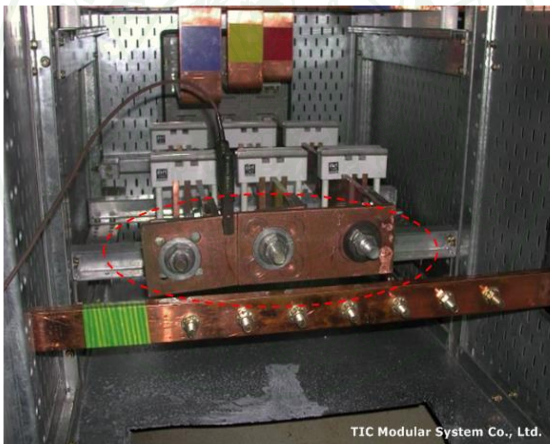
ภาพที่ 64 จุดต่อลัดวงจรวงจรด้านนอกของหน่วยมีหน้าที่ (เซอร์กิตเบรกเกอร์)
