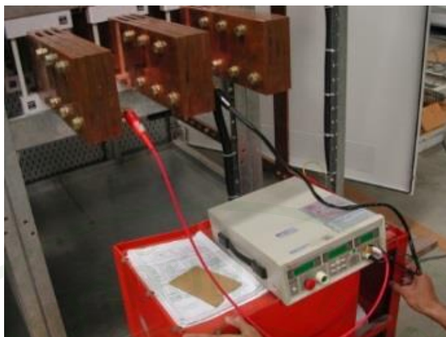
ภาพที่ 39 การป้อนแรงดันไฟฟ้าทดสอบระหว่างตัวนำเฟส
