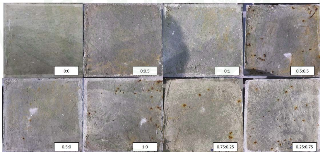
ภาพที่ 28 การเกิดสนิมเป็นจุดบริเวณผิวหน้าของคอนกรีตตัวอย่างในสภาวะอิมมัวจากคลอไรด์ตลอดเวลา
