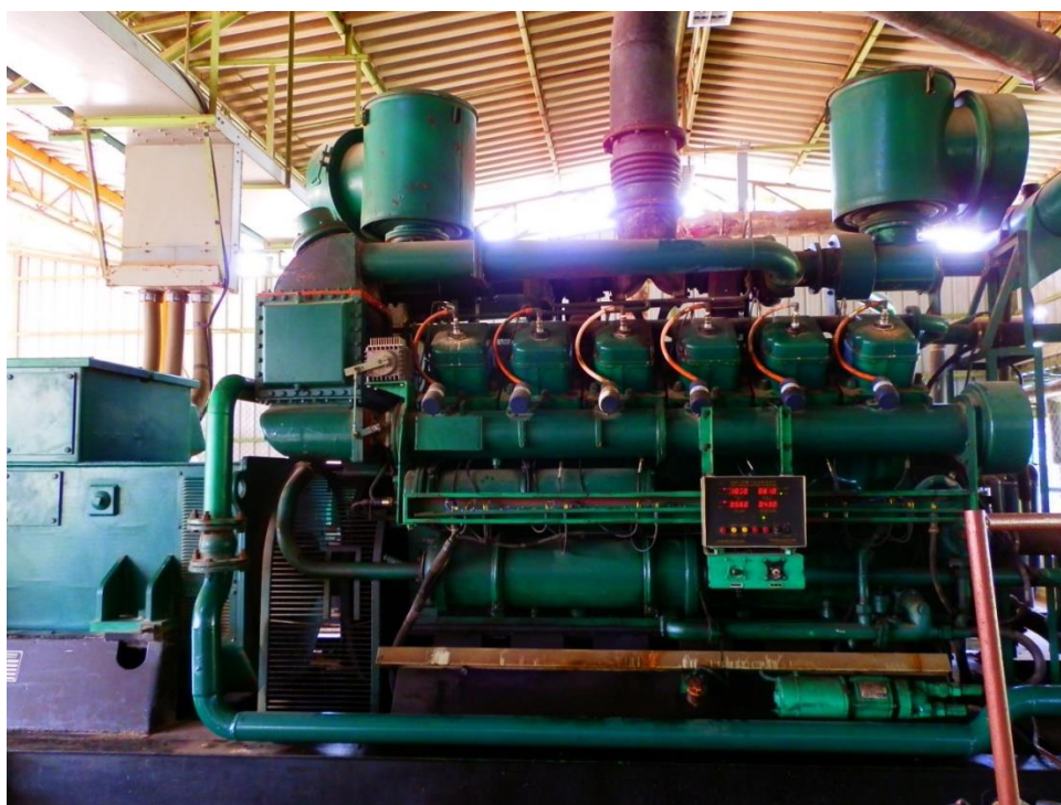
รูปที่ 4.13 เครื่องยนต์ก๊าซชีวภาพของโรงงาน (Biogas Engine Generator)
