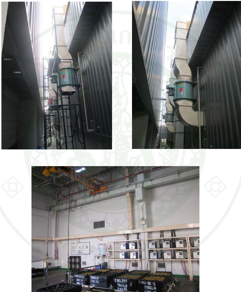
ภาพผนวกที่ 10 ระบบระบายอากาศใหม่ที่ติดตั้งในห้องชาร์ตแบตเตอรี่
