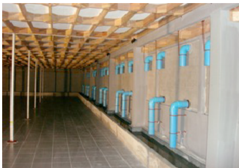
ภาพที่ 7 รางเก็บน้ำภายในอาคาร
