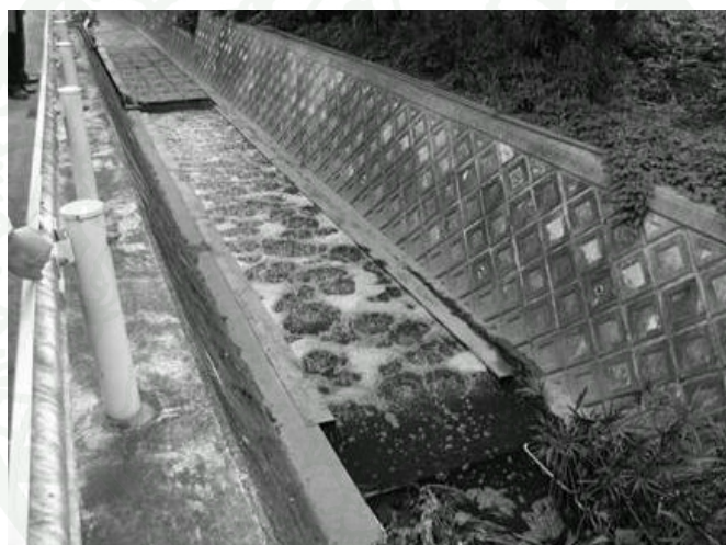
ภาพที่ 6 คอนกรีตพูนสำหรับกรองน้ำเสียและสิ่งปฏิกูล
