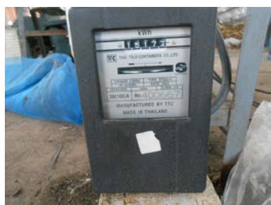
มิเตอร์ไฟฟ้า
