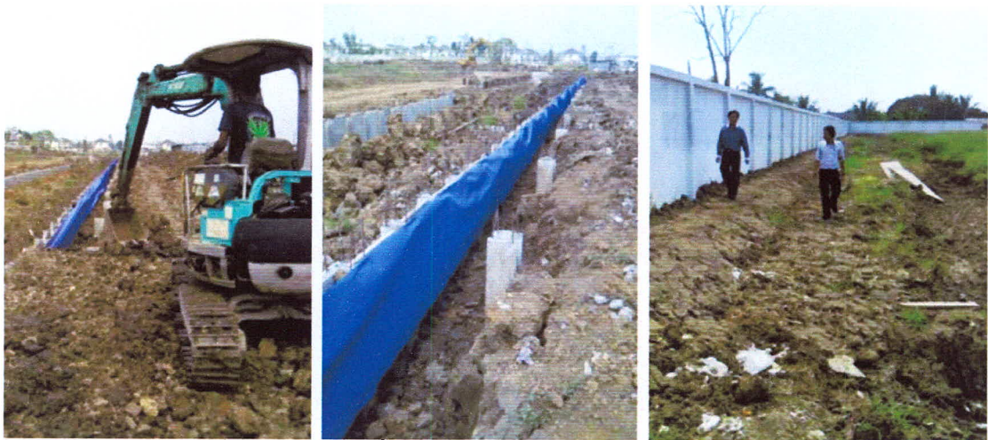
รูปที่ 5.48 แสดงรูปรั้วโครงการที่ติดสวนหรือมีพื้นที่ภายในแคบ
