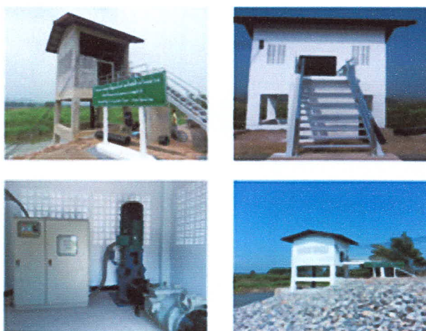
รูปที่ 5.35 สถานีสูบน้ำเพื่อป้องกันอุทกภัย
