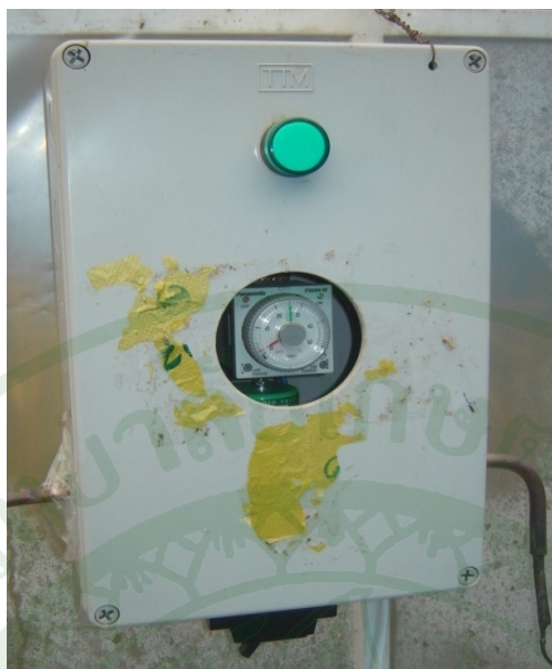
ภาพที่ 7 อุปกรณ์ควบคุมการปล่อยก๊าซคาร์บอนไดออกไซด์เข้าในโรงเรือน
