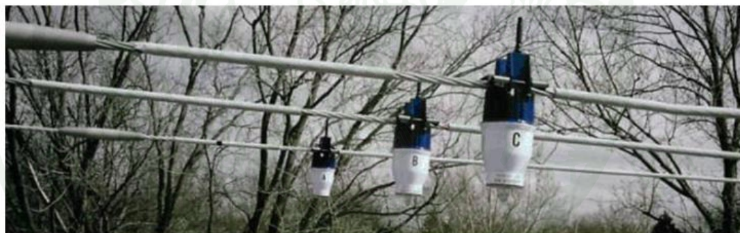
ภาพที่ 7 อุปกรณ์ซึ่งบอกความผิดปกติพร้อมชนิดติดตั้งที่สายไฟของระบบจำหน่ายเหนือดิน
