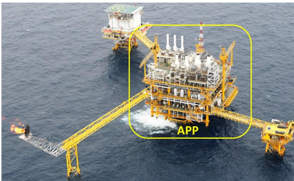
ภาพที่ 6 ภาพแสดงแท่นผลิตก๊าซธรรมชาติ โครงการอาทิตย์ (Arthit Processing Platform, APP)
