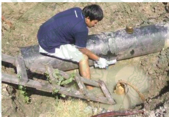
ภาพที่ 24 การวัดอัตราการไหลในท่อส่งน้ำเสียโดยใช้คลื่นความถี่เหนือเสียงแบบ ultrasonic transit-time flow meter
