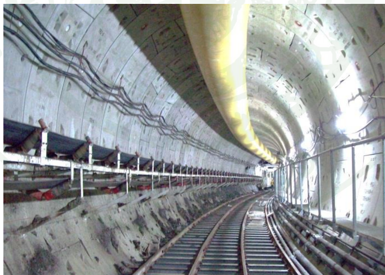
ภาพที่ 11 สายพานลำเลียงดิน (Belt conveyor)
