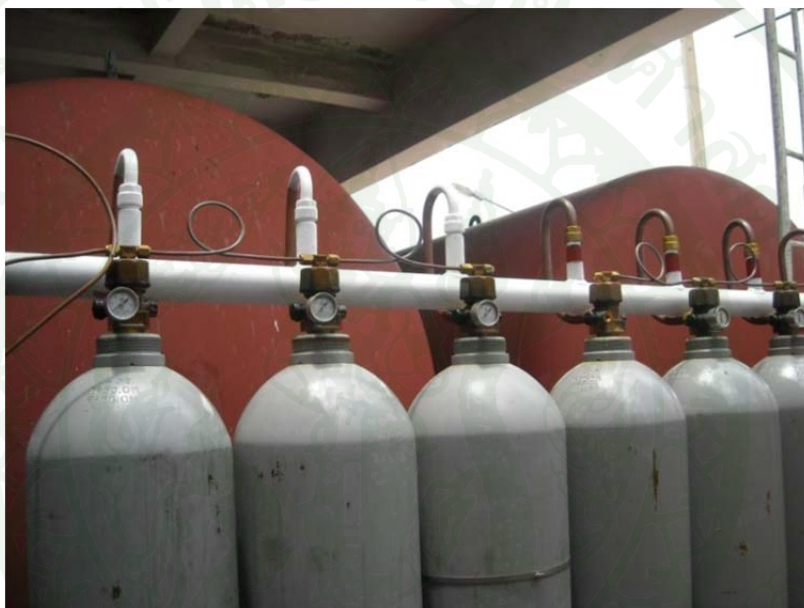
ภาพที่ 133 การรั่วของไนโตรเจนที่บริเวณท่อร่วม
