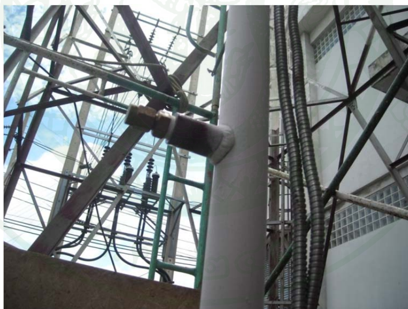
ภาพที่ 137 ก๊าซไนโตรเจนที่รั่วบริเวณ Safety Vent
