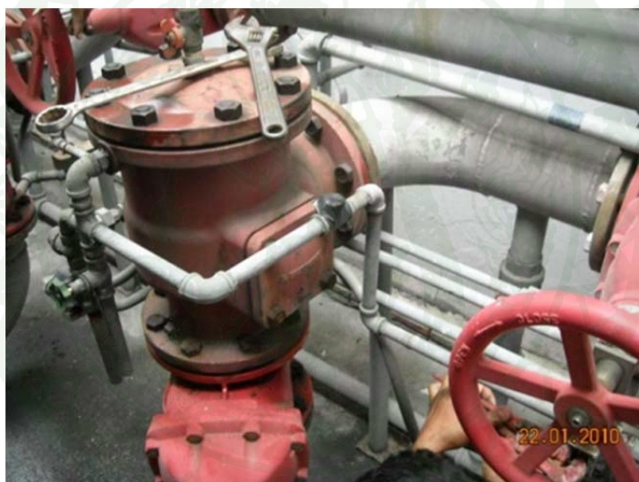
ภาพที่ 67 วาล์วควบคุมสั่งงาน (Deluge Valve)
