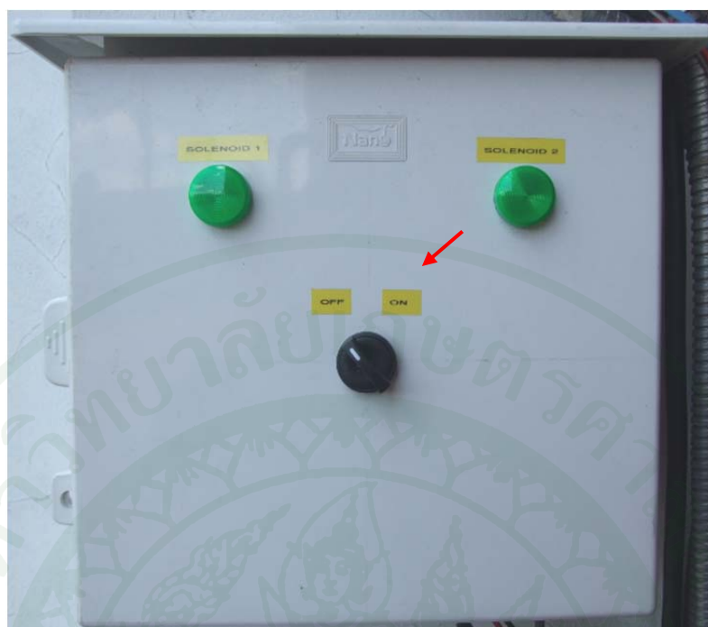
ภาพที่ 118 ตู้ควบคุมการทำงานของระบบดับเพลิง
