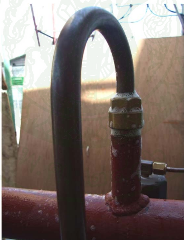
ภาพที่ 146 สังเกตจุดที่รั่วจะมีฟองอากาศออกมา
