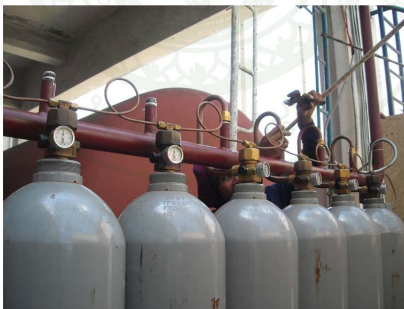
ภาพที่ 51 ต่อท่อทองแดงเชื่อมต่อถังเก็บไนโตรเจน (Storage Cylinder)
