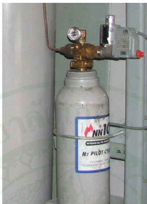
ภาพที่ 33 ถังนำไนโตรเจน (Pilot Cylinder)
