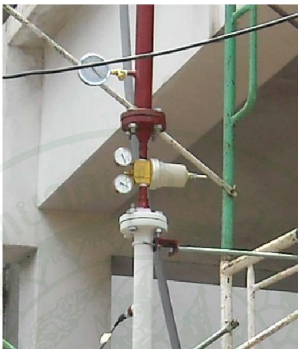
ภาพที่ 138 ก๊าซไนโตรเจนที่รั่วบริเวณหน้าแปลน
