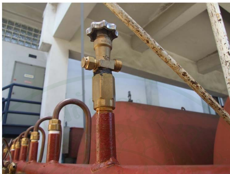
ภาพที่ 141 วาล์วสำหรับทดสอบการรั่วที่ถูกติดตั้งที่ท่อร่วม
