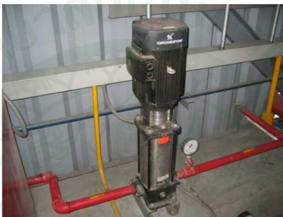
ภาพที่ 13 แสดงเครื่องสูบน้ำเติมในถังเก็บน้ำความดัน
