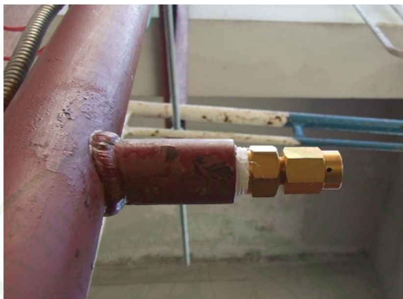
ภาพที่ 151 Safety Vent หรือ Gas Vent ที่เปลี่ยนใหม่
