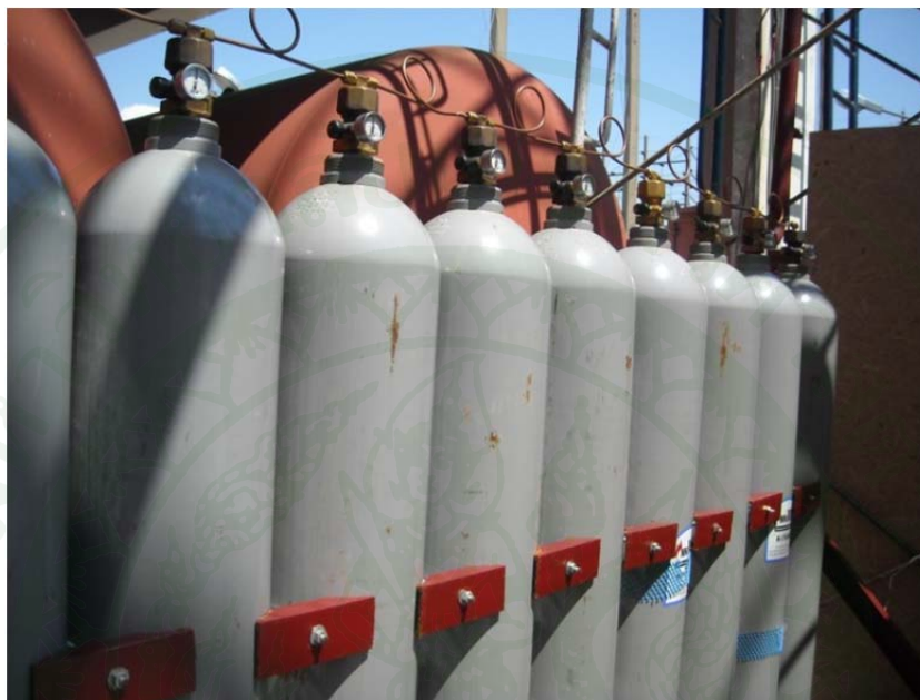
ภาพที่ 50 การยึดถังเก็บไนโตรเจนกับแท่นรองรับถังเก็บไนโตรเจนให้แน่น
