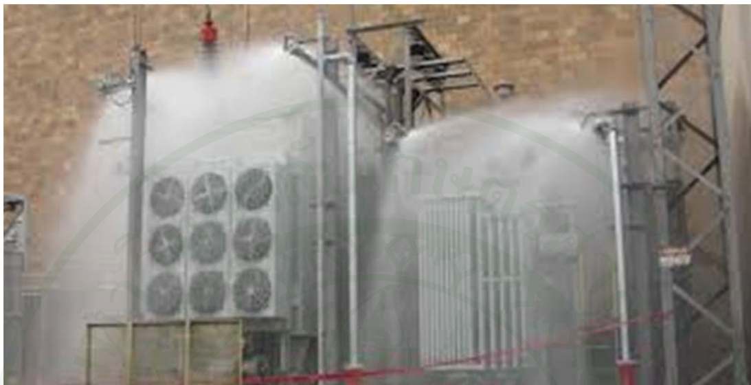
ภาพที่ 3 แสดงการฉีดน้ำฝอยดับเพลิง
