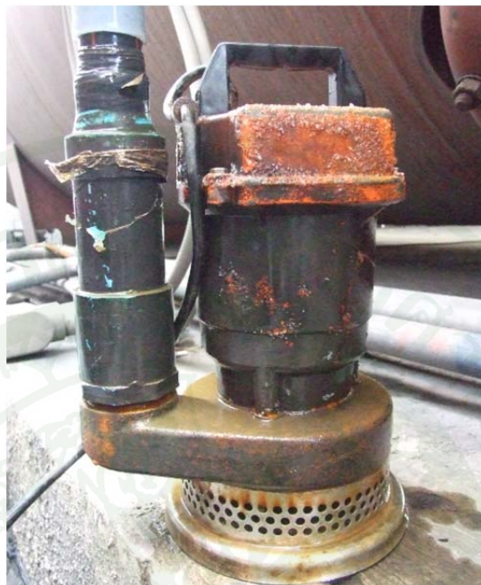
ภาพที่ 107 ปั้มน้ำที่ใช้เติมน้ำเข้าถังน้ำดับเพลิง
