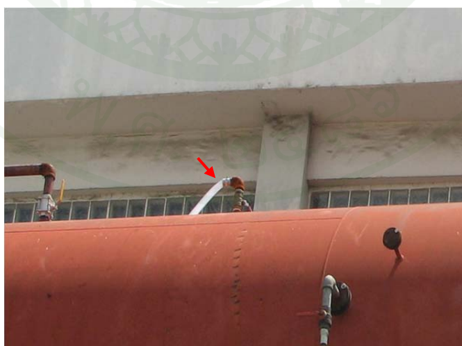
ภาพที่ 106 ต่อสายยางเติมน้ำเข้าถังน้ำดับเพลิง
