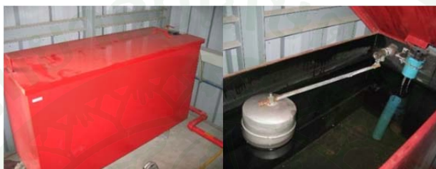
ภาพที่ 15 ถังพักน้ำสำหรับเพิ่มเข้าถังเก็บน้ำความดัน
