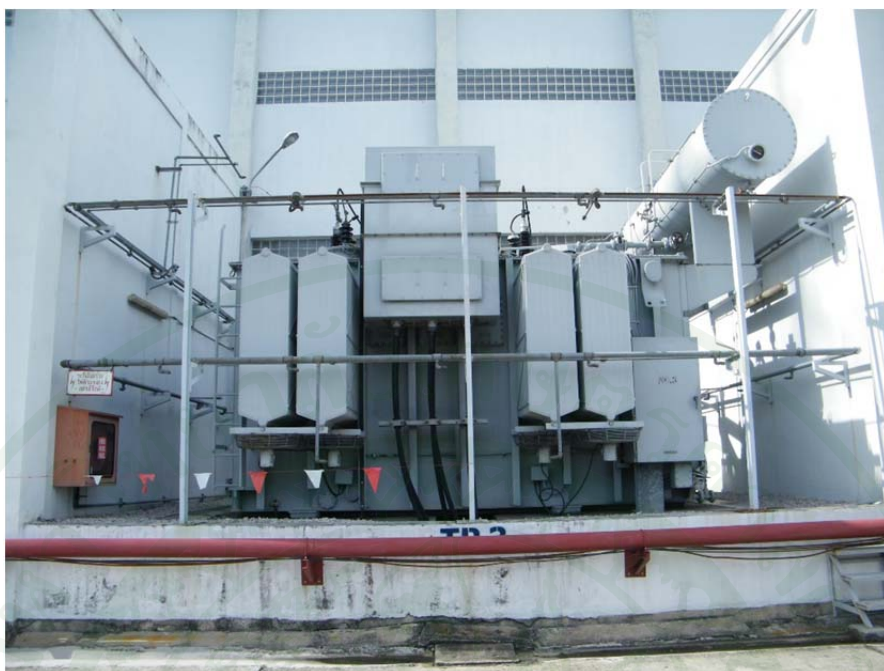
ภาพที่ 17 ระบบกระจายน้ำฝอยดับเพลิงของหม้อแปลง
