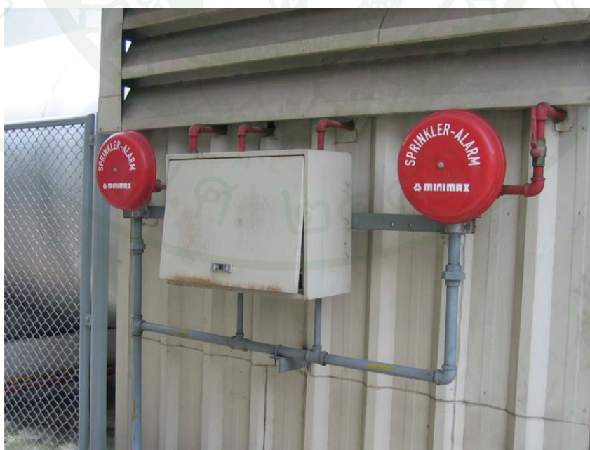
ภาพที่ 10 อุปกรณ์แจ้งเตือนแบบระฆังน้ำ
