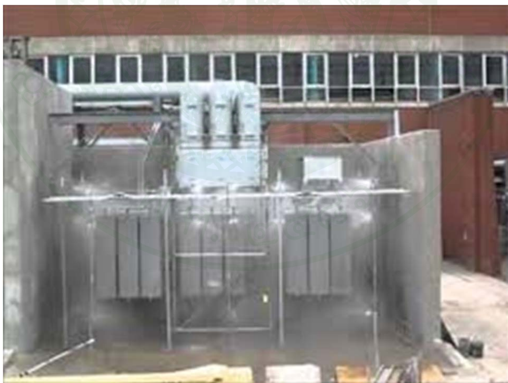
ภาพที่ 2 แสดงการทำงานของระบบ Water Spray
