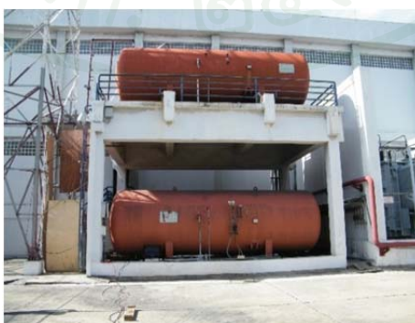
ภาพที่ 16 ถังเก็บน้ำความดัน (Pressure Water Tank)
