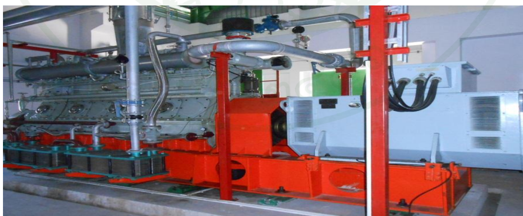
ภาพที่ 11 เครื่องกำเนิดไฟฟ้า
