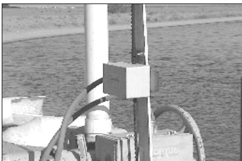
ภาพที่ 12 อุปกรณ์วัดระยะเปิดประตูระบายน้ำ
