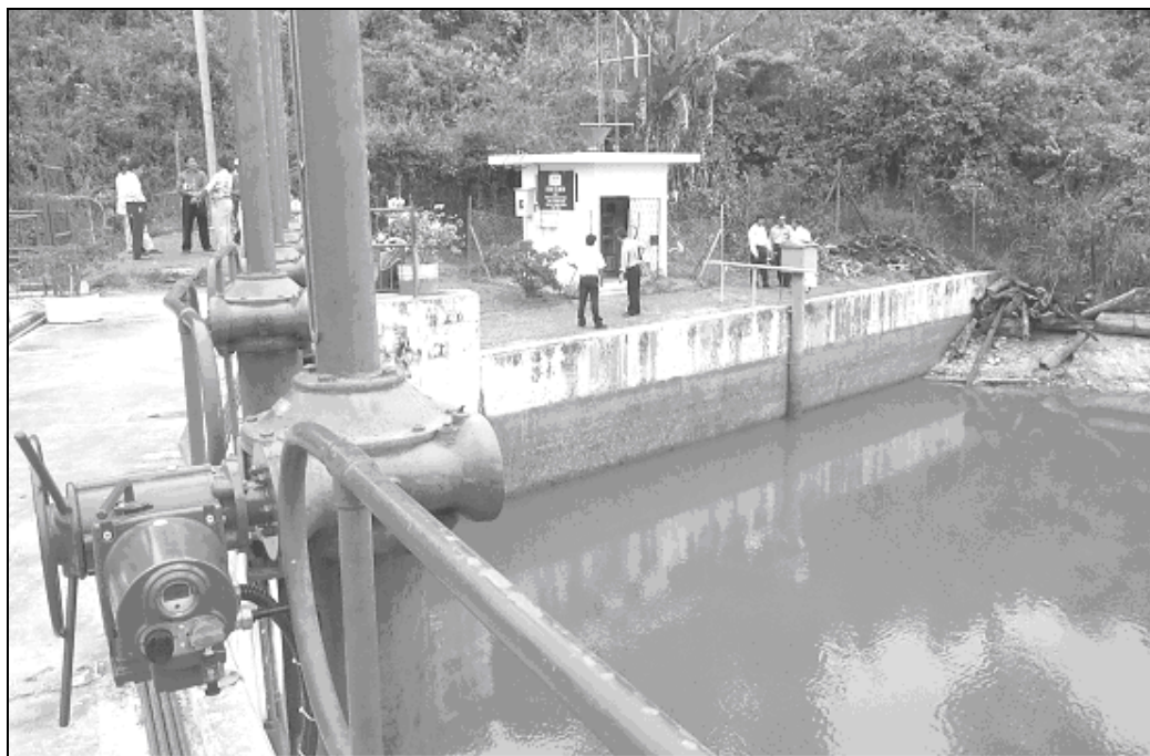
ภาพที่ 15 The Kerian Irrigation Scheme ในประเทศมาเลเซียติดตั้งอุปกรณ์ ตรวจวัดระดับน้ำและควบคุมระยะการเปิดบานประตู
