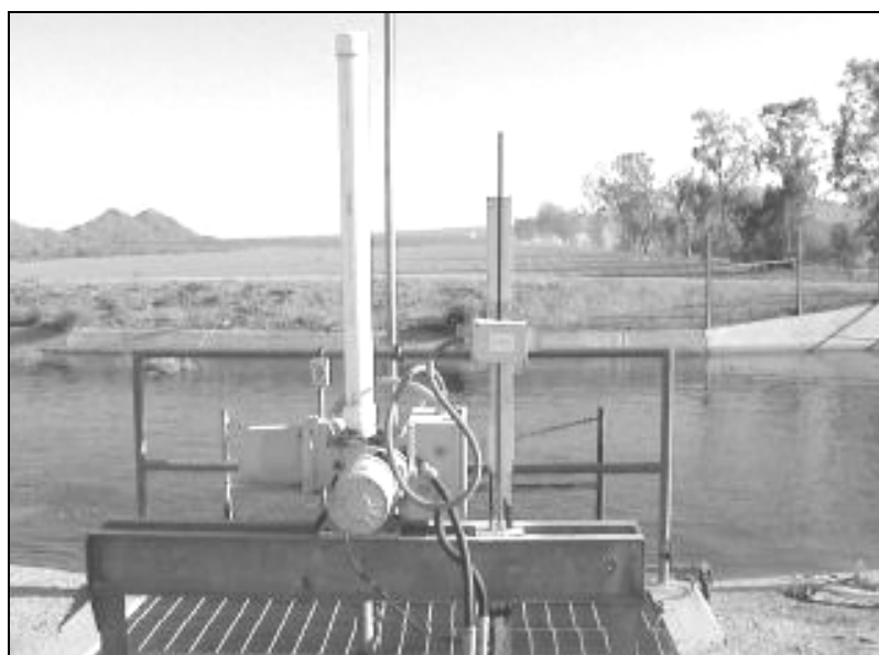
ภาพที่ 11 เกียร์มอเตอร์เปิด-ปิดประตูระบายน้ำ
