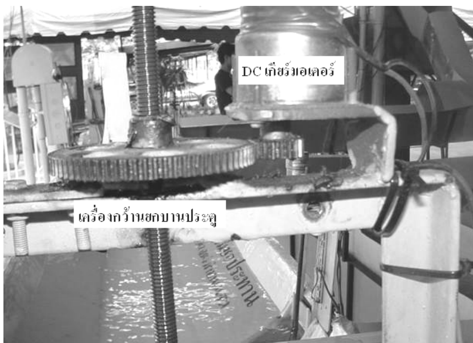
ภาพผนวกที่ ก4 DC เกียร์มอเตอร์สำหรับเปิด – ปิด ประตูระบายน้ำ
