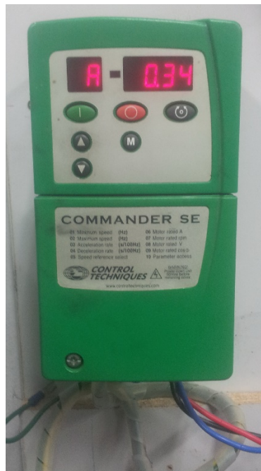
รูปที่ ข-3 อินเวอร์เตอร์ใช้ในการควบคุมการทำงานของพัดลมดูดอากาศ
