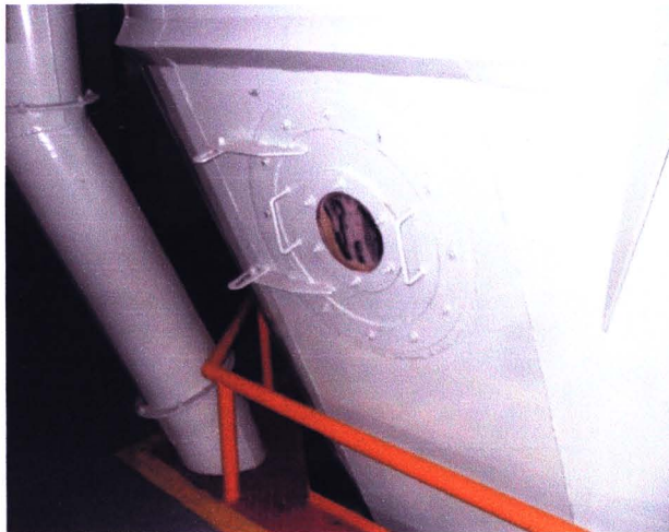
รูป 4.40 Hopper ตาชั่งยังไม่มีติดตั้งระบบสวิตช์ประตู (Door Switch) และ อุปกรณ์ Emergency Switch
