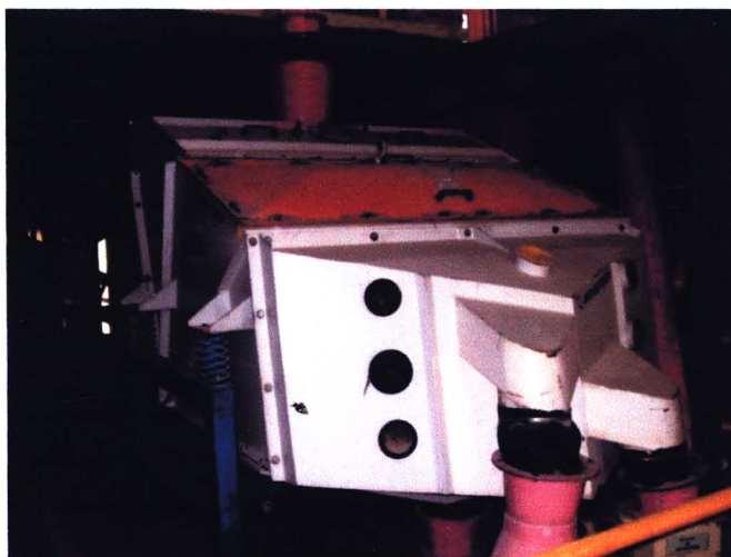
รูป 4.39 เครื่องร่อนเมล็ดยังไม่มีติดตั้งระบบสวิทช์ประตู (Door Switch) และ อุปกรณ์ Emergency Switch
