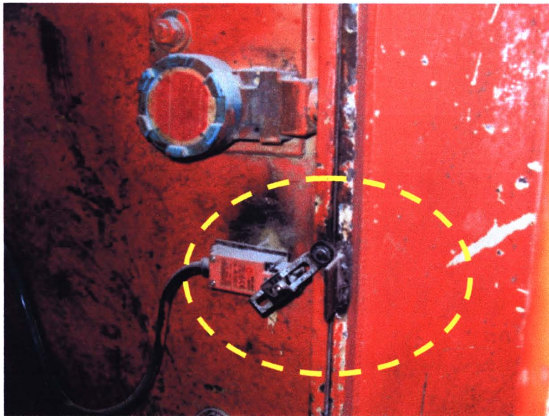
รูป 4.34 แสดงระบบเซนเซอร์ (Sensor) ที่ ประตูเครื่องบด
