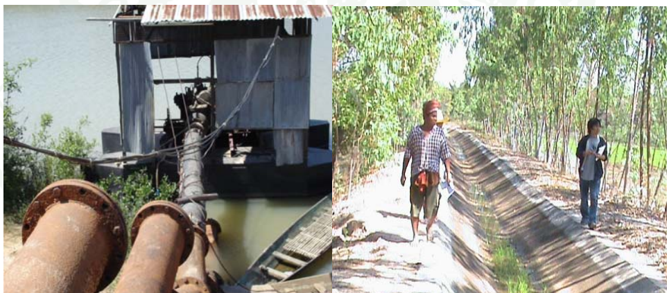
ภาพที่ 48 สถานีสูบน้ำด้วยไฟฟ้าและคลองกระจายน้ำคอนกรีต
