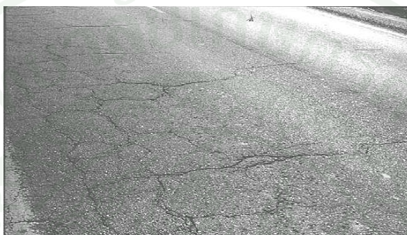
ภาพที่ 7 ความเสียหายแบบ Block Cracking
