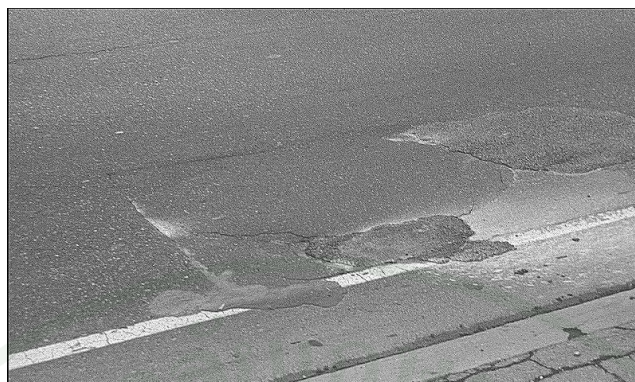
ภาพที่ 10 ความเสียหายแบบ Patching and Utility Cut Patch
