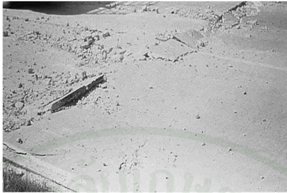
ภาพที่ 15 ความเสียหายแบบ Blowup
