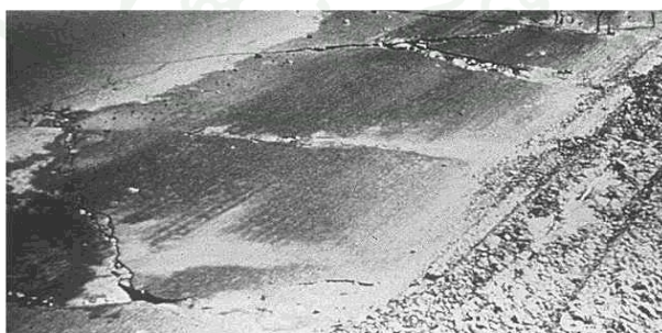
ภาพที่ 20 ความเสียหายแบบ Pumping
