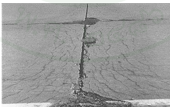
ภาพที่ 18 ความเสียหายแบบ Durability cracking
