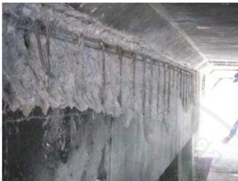
ภาพผนวกที่ ค12 การสกัดเปิดผิวคอนกรีตบริเวณรอบเหล็กเสริมที่เกิดสนิม
