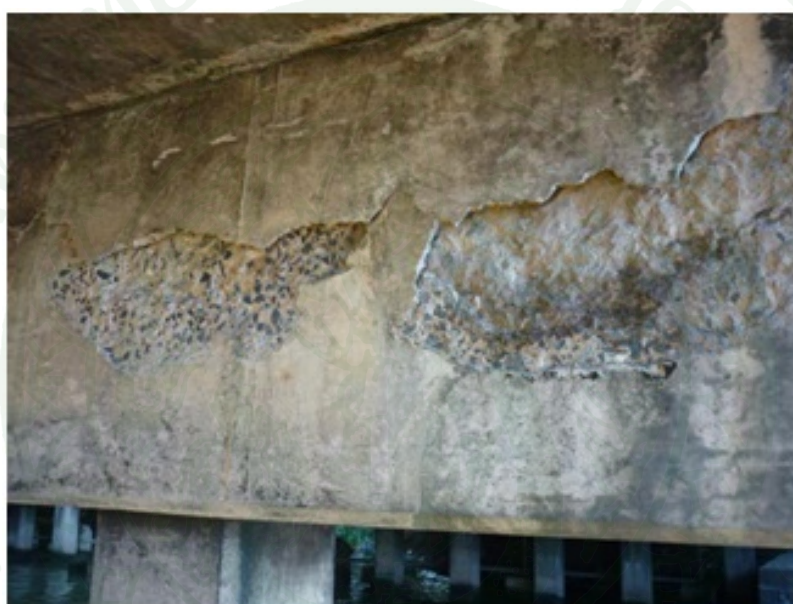
ภาพผนวกที่ ค5 ลักษณะความเสียหายของโครงสร้างสะพานคอนกรีตเสริมเหล็ก
