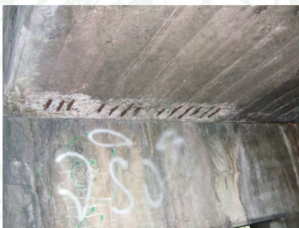
ภาพผนวกที่ ก2 ผิวคอนกรีตหลุดล่อนใต้พื้นสะพานจนเห็นเหล็กเสริมบริเวณจุดรองรับพื้นสะพาน
