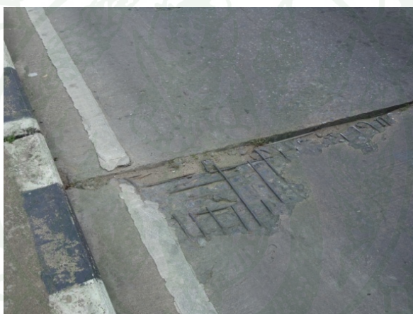
ภาพผนวกที่ ก5 คอนกรีตหลุดล่อนบนผิวจราจรจนเห็นเหล็กเสริม
