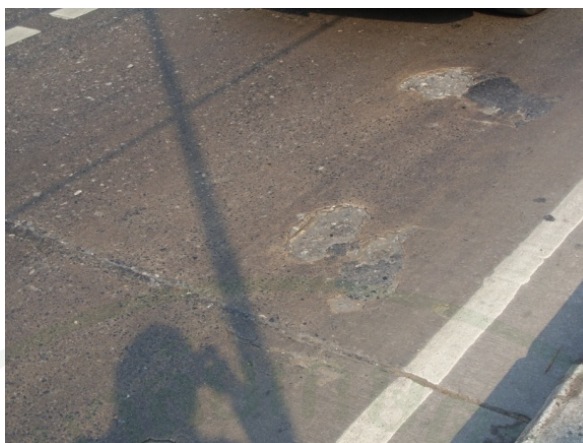
ภาพผนวกที่ ก4 คอนกรีตหลุดล่อนบนผิวจราจร
