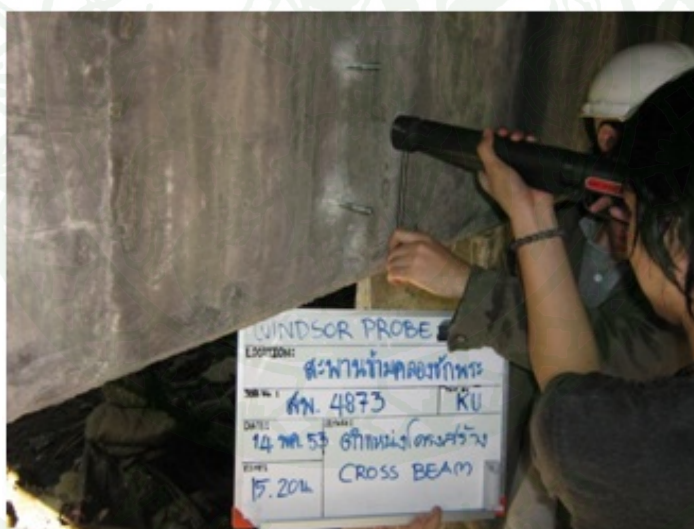
ภาพที่ 30 การทดสอบหาค่ากำลังของคอนกรีตในสนามด้วยการวัดกำลังต้านทานการทะลวง ณ ตำแหน่งคานขวาง
