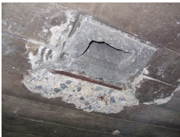
ภาพผนวกที่ ก1 ผิวคอนกรีตหลุดล่อนใต้พื้นสะพานบริเวณช่องระบายน้ำ
