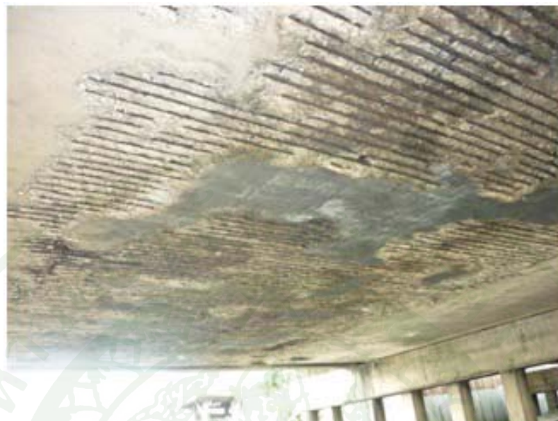
ภาพผนวกที่ ค11 ลักษณะโครงสร้างสะพานส่วนพื้นถูกการกัดกร่อนจากสนิมเหล็ก
