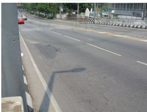
ภาพผนวกที่ ก6 ผิวจราจรมีรอยแตกถายางและวัสดุผิวทางเสื่อมสภาพ
