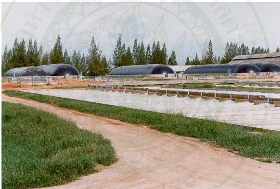
ภาพที่ 4.1 ระบบก๊าซชีวภาพขนาด 5,000 ลบ.ม พร้อมระบบบำบัดขั้นหลังณ เอส.พี.เอ็ม.
