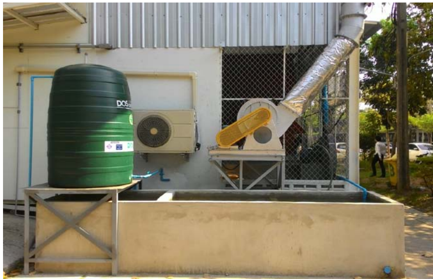
ภาพที่ 5.18 บ่อตกตะกอน และพัดลมดูดไอเสีย
