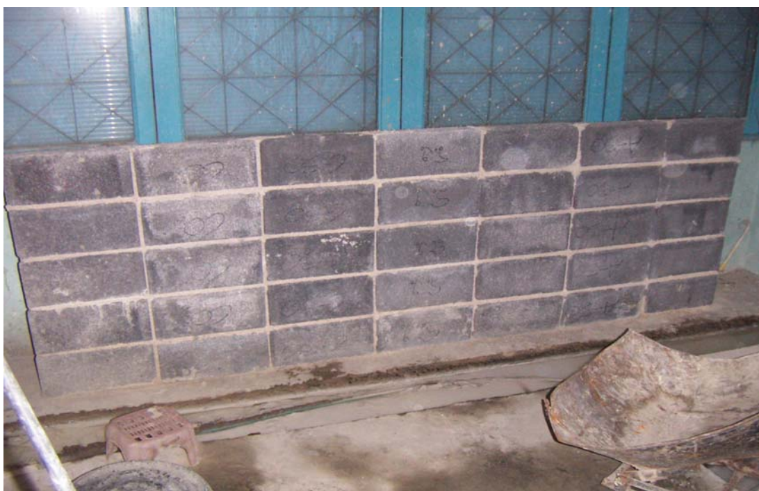
ภาพที่ 29 ผนังคอนกรีตบล็อกก่อโดยไม่มีการฉาบให้สัมผัสกับน้ำโดยตรง
